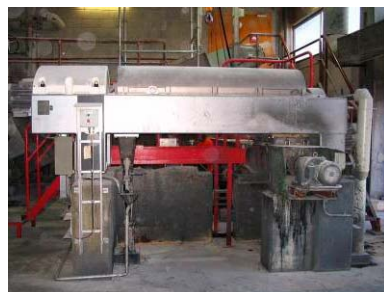
Sistema de deshidratado de lodos Alfa Laval.
